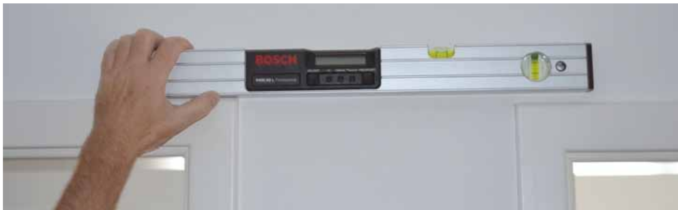
15mm Höhenversatz zwischen Bad und Schlafzimmertür – hier ist festzustellen, ob das Niveau der Badfliese oder die Montage das eigentliche Problem ist?
